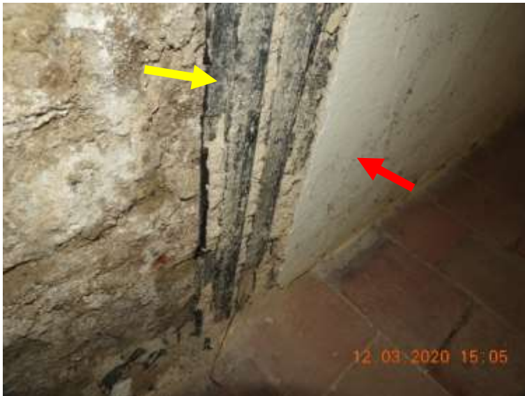
Bild 2: Detailansicht zu Bild 1 Gelber Pfeil: teerhaltige Welltafeln Roter Pfeil: Innenputz
