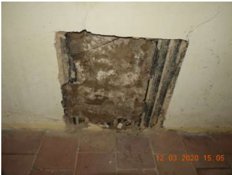
Bild 1: bauseitiger Öffnungsbereich Putz Südwand – stark durchfeuchtetes Mauerwerk: Versuch der Sanierung teerhaltige Dichtungsbahn verputzt
